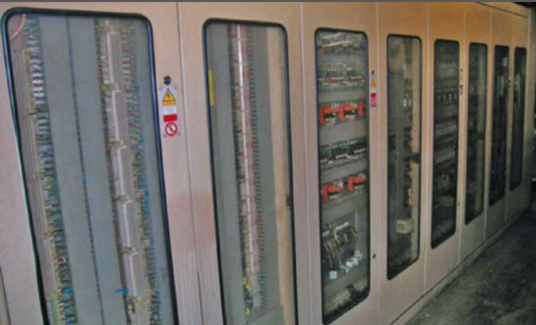
Abb. links: Der neue Reifen P Zero, daneben ein Teil der Produktionsanlage der O°-Nylon-Fertigung sowie der die Produktion steuernden Schaltschränke.
